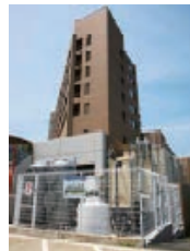
国立病院機構水戸医療センターに設置された「地下水膜ろ過システム」(東日本大震災の際、このシステムが多くの命を救った)
