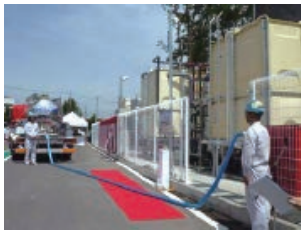
日野自動車株式会社に設置された「地下水膜ろ過システム」(2012年8月のシステム導入を契機に羽村市と災害協定を締結)
