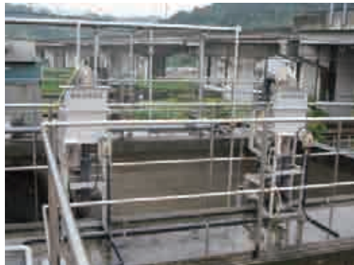
▶ 排水処理場酸素供給
